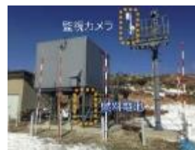
火山防災監視 (監視カメラ)
