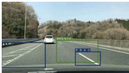
走行中車両からの路面劣化診断 (剥離・劣化等)
