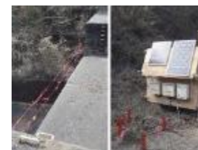
火山土石流監視 (ワイヤーセンサー)
