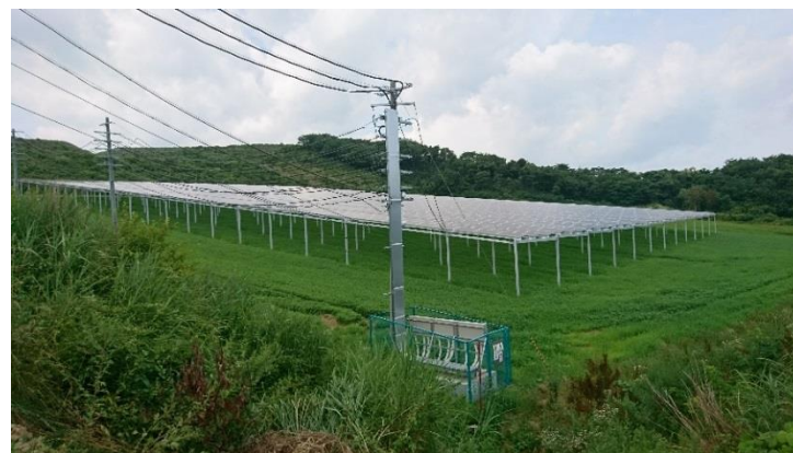
一関市吉高太陽光発電所
