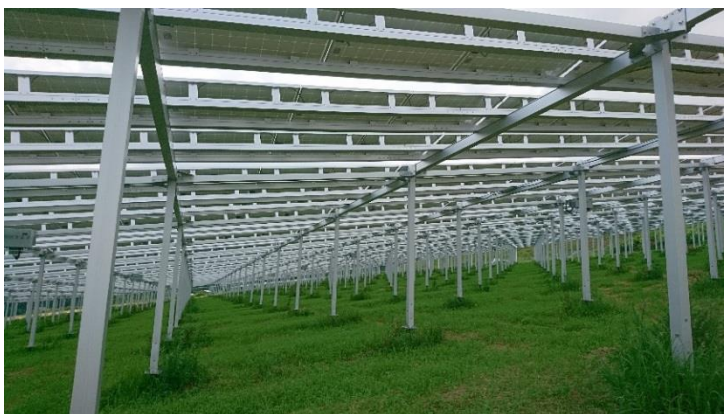
一関市吉高太陽光発電所
