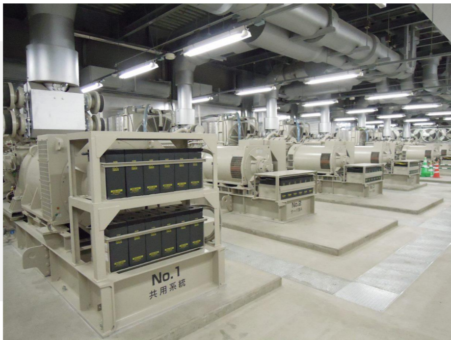
▲石狩データセンターの非常用発電機
