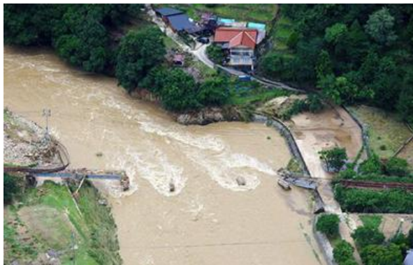
芸備線（白木山～狩留家駅間） 第1三篠川橋桁流出
