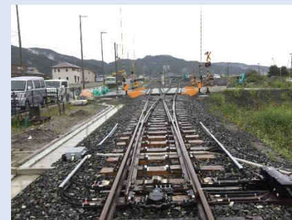
山田線信号設備 (震災復旧) (岩手県)
