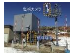
火山防災監視 (監視カメラ)
