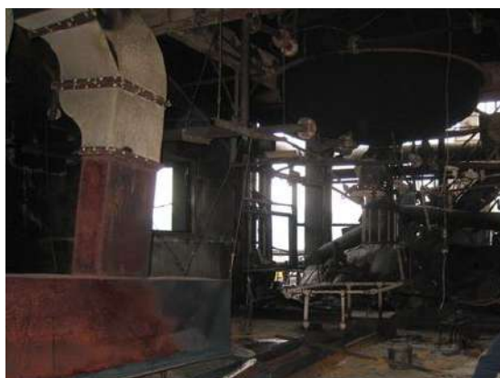
図 92 崩壊した南固化室西壁
