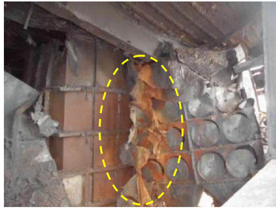
図 84 角ダクトの残がい
