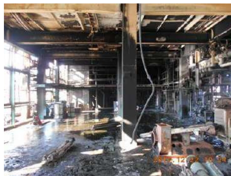
図 80 熱媒油で汚れた 2階床面
