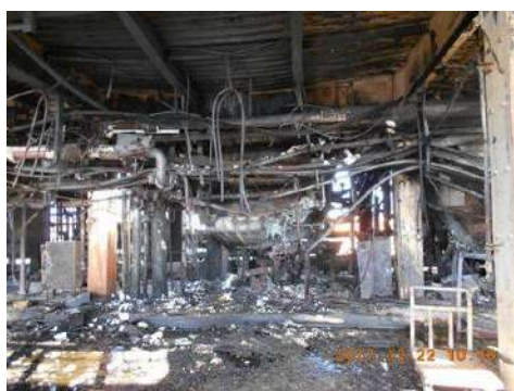
図 104 3階製造釜B付近の焼損状況
