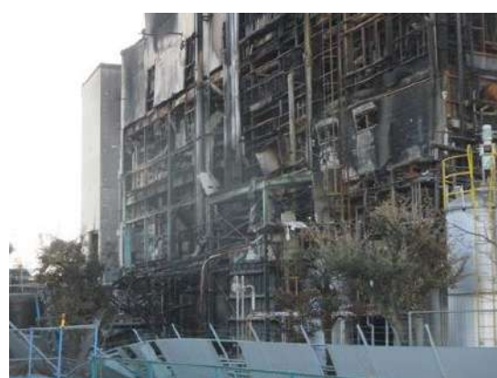
図 95 発災後の製造棟北壁
