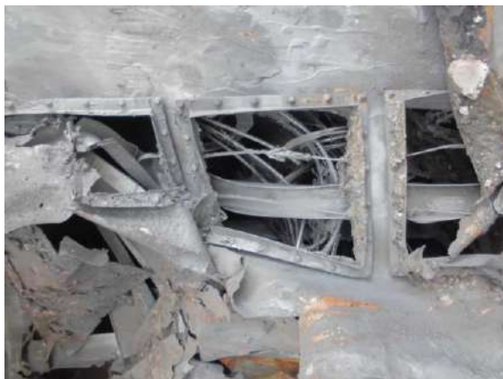
図74 集じん機の放散口
