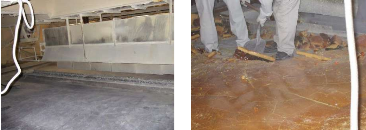
図 42 固化室内部の状況（北固化室，発災前）
