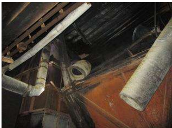
図76 エルボ一部分が外れたダクト
