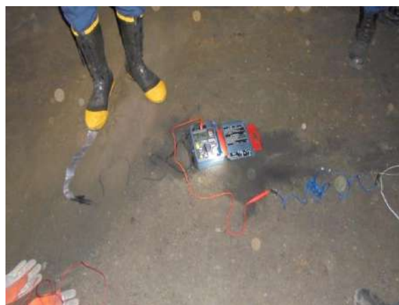
図 49 1階床と接地極の間の抵抗測定の状態
