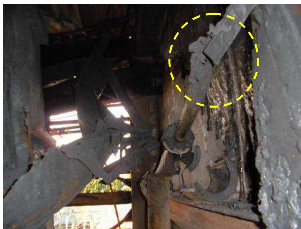
図 98 破断した配管
