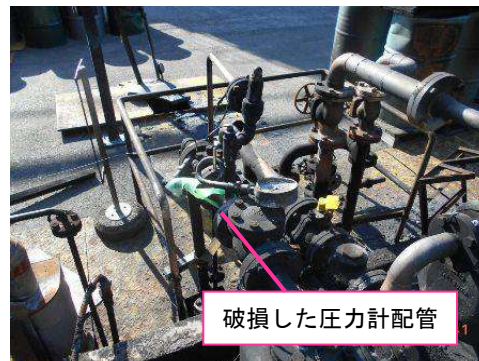
図 82 破損した圧力計配管（キシレンポンプ周辺）
