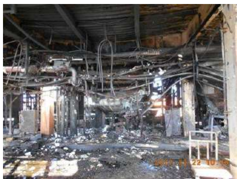
図 79 3階製造釜 B 付近の焼損状況
