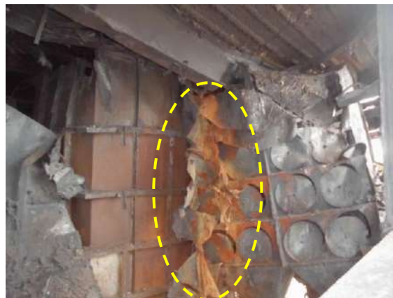
図75 角ダクトの残がい
