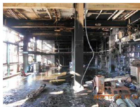
図 105 熱媒油で汚れた2階床面
