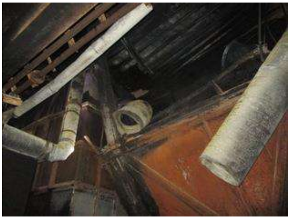
図 85 エルボ一部分が外れたダクト
