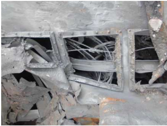
図 83 集じん機の放散口
