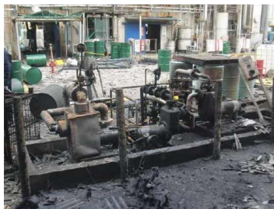
図 23 ② キシレンポンプ
