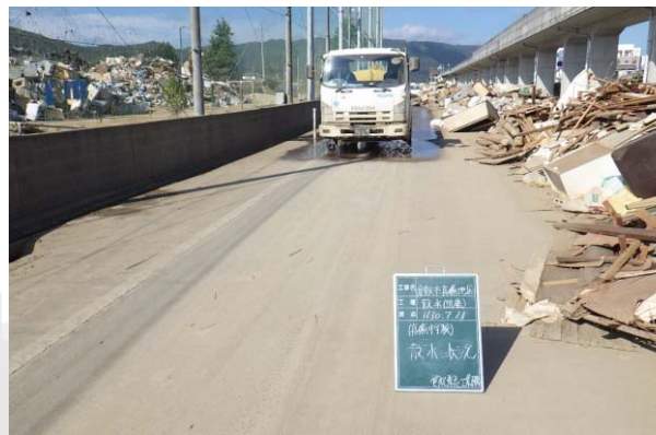
岡山県倉敷市真備町
