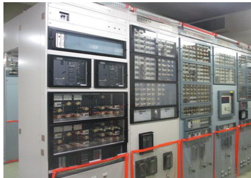
更新前遠方監視制御装置
