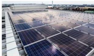
太陽光パネル
