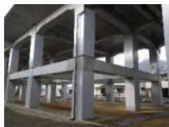
高架橋柱 (せん断破壊先行型)
