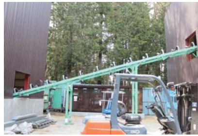
木くずを運搬するベルトコンベア (実際の稼働時にはカバーをかけ、飛散防止)
