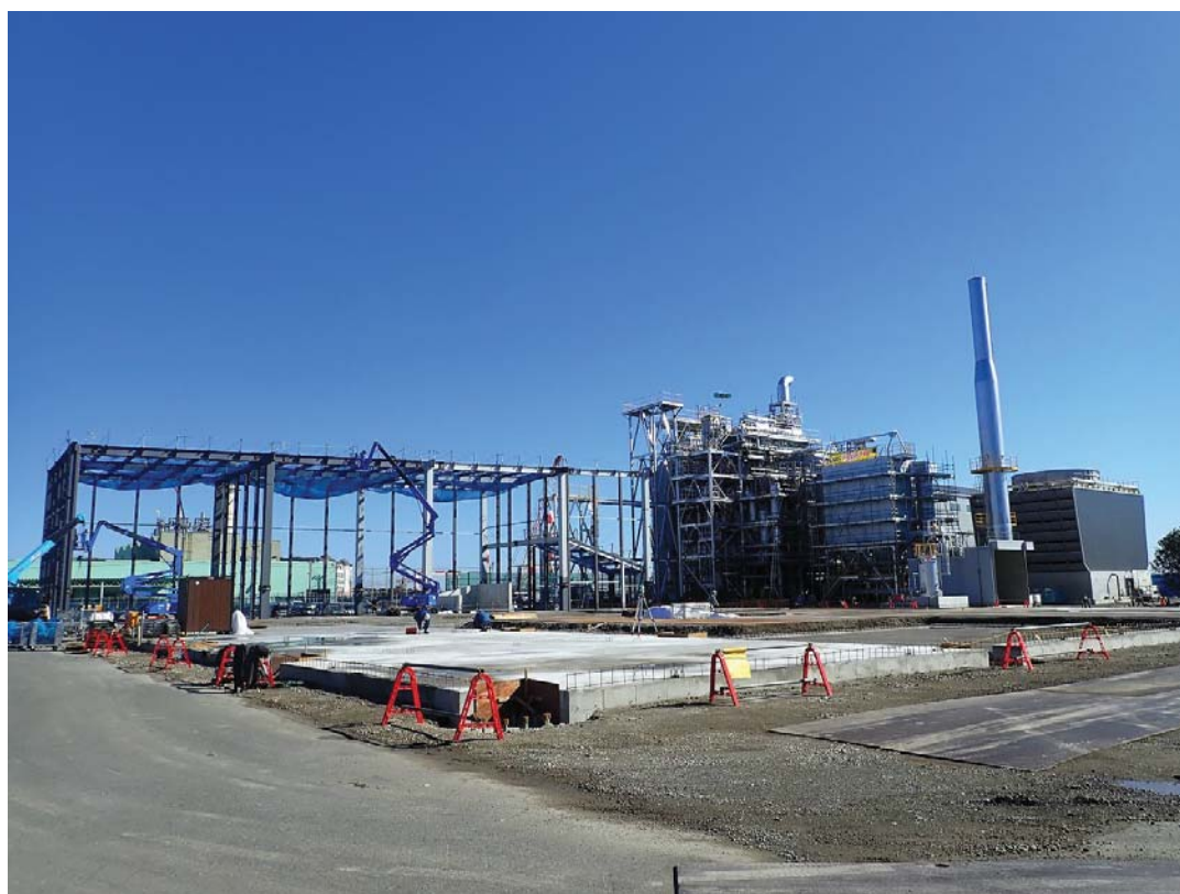
（株）横須賀バイオマスエナジー（3月撮影）。画面右手は発電設備。左側は燃料棟。
