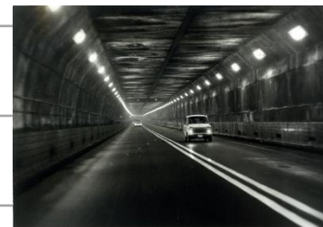
関門海底トンネル照明器具
