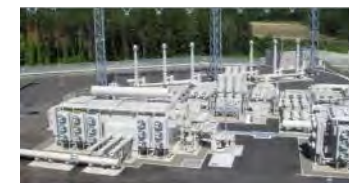
変電所、遮断器、変圧器
