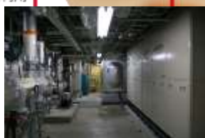
地中熱や温泉排熱を空調や給湯の熱源にするヒートポンプ設備
