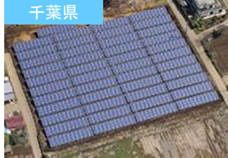
S-03 LS千葉若葉区発電所
