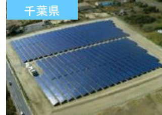
S-06 LS匝瑳発電所
