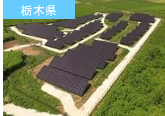
S-15 LS藤岡A発電所
