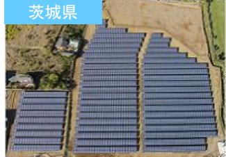
S-11 LS神栖波崎発電所
