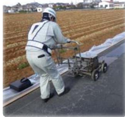
予防保全のための常温表面処理工法 (補修材料：アスファルト乳剤)
