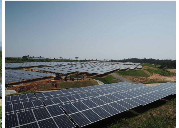
いちご名護二見ECO発電所 (沖縄県名護市)
