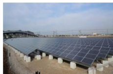
太陽光第一発電所
