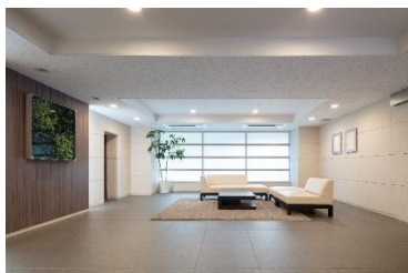
LED照明の導入
