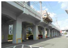
高架橋柱 (曲げ破壊先行型)
