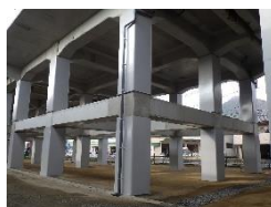
高架橋柱 (せん断破壊先行型)
