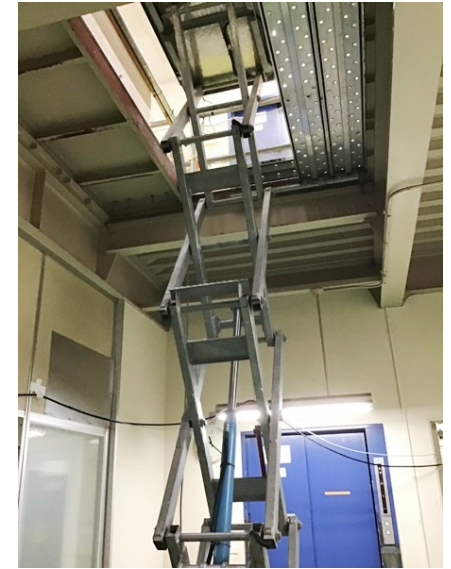
エレベータ故障にて 昇降機を仮設
