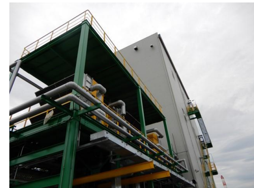
新設した特殊ポリカーボネート「ユピゼータ®EP」製造プラント（鹿島工場）
