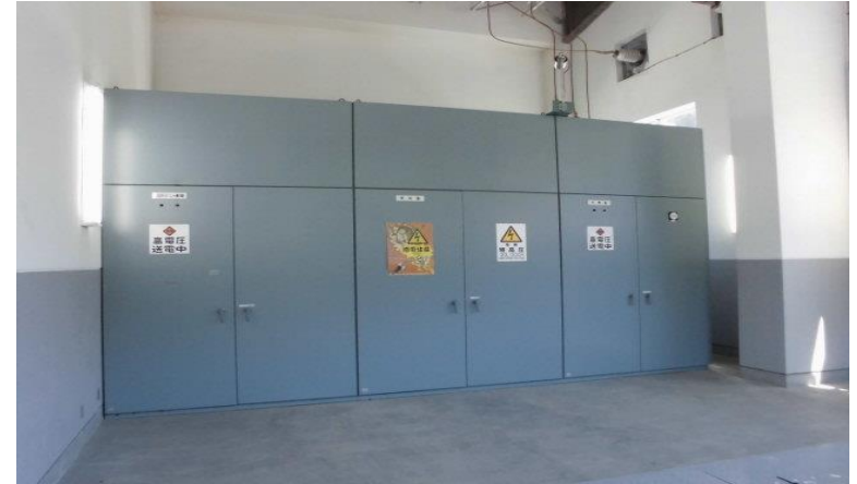
30kV開閉設備
