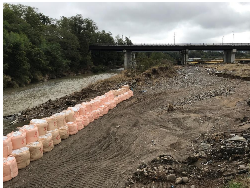
千曲川支川滑津川破堤箇所
