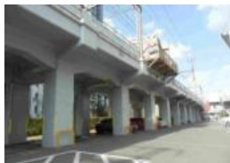
高架橋柱 (曲げ破壊先行型)
