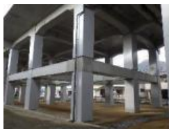
高架橋柱 (せん断破壊先行型)
