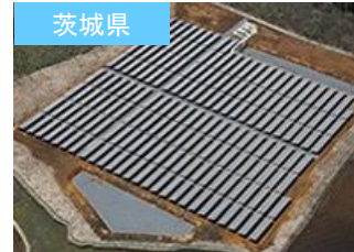
S-08 LS水戸高田発電所
