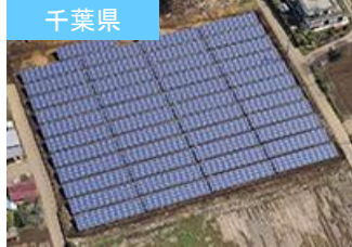
S-03 LS千葉若葉区発電所
