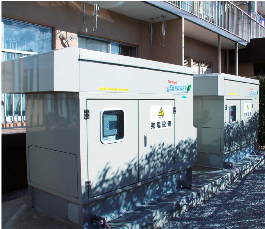
LPガス非常用発電機
