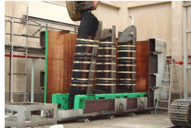
大型変圧器 (トランス)
