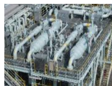
新型熱量調整設備
