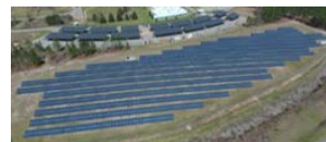
SAE社が過去に開発・建設した 太陽光発電所 提供：SolAmerica Energy社
