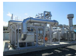
“Kフィルター” VOC回収装置
