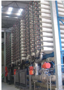
アルジェリアの海水淡水化プラント
