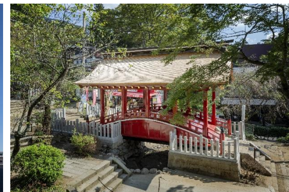
金剛組 (茨城県つくば市) 茨城県指定文化財筑波山神社神橋(しんきょう)修理工事
