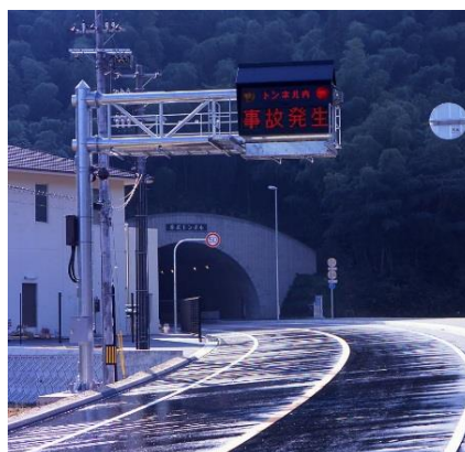
トンネル警報表示板 (トンネル防災システム)
