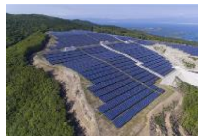
S-06 長崎琴海太陽光発電所
