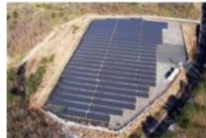
S-04 JEN玖珠太陽光発電所
