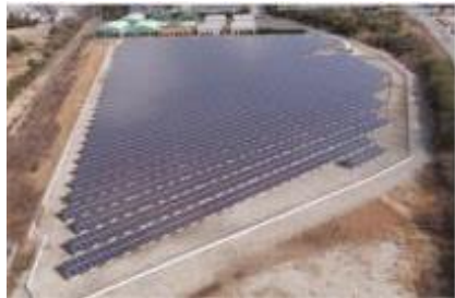
S-03 JEN防府太陽光発電所
