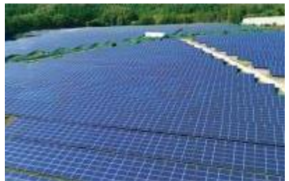
S-05 鉾田太陽光発電所
