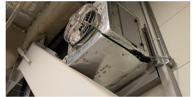
産業用有圧換気扇 6基で強力換気 約2時間で全ての空気を入れ替え
