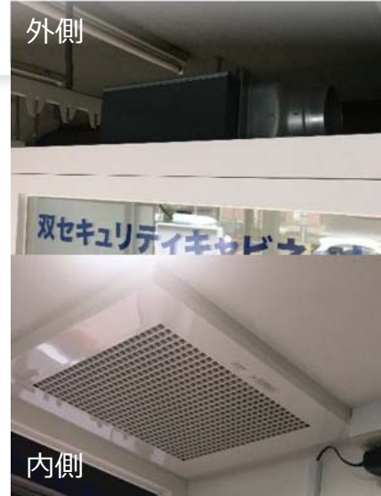
換気システム
