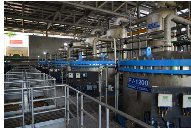
稼働を開始したセラミック膜ろ過施設(CeraMac®)
