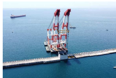
和歌山下津港北港地区防波堤(南)災害復旧工事(第1工区)(和歌山県)
