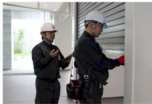
防火シャッターの法定点検のイメージ
