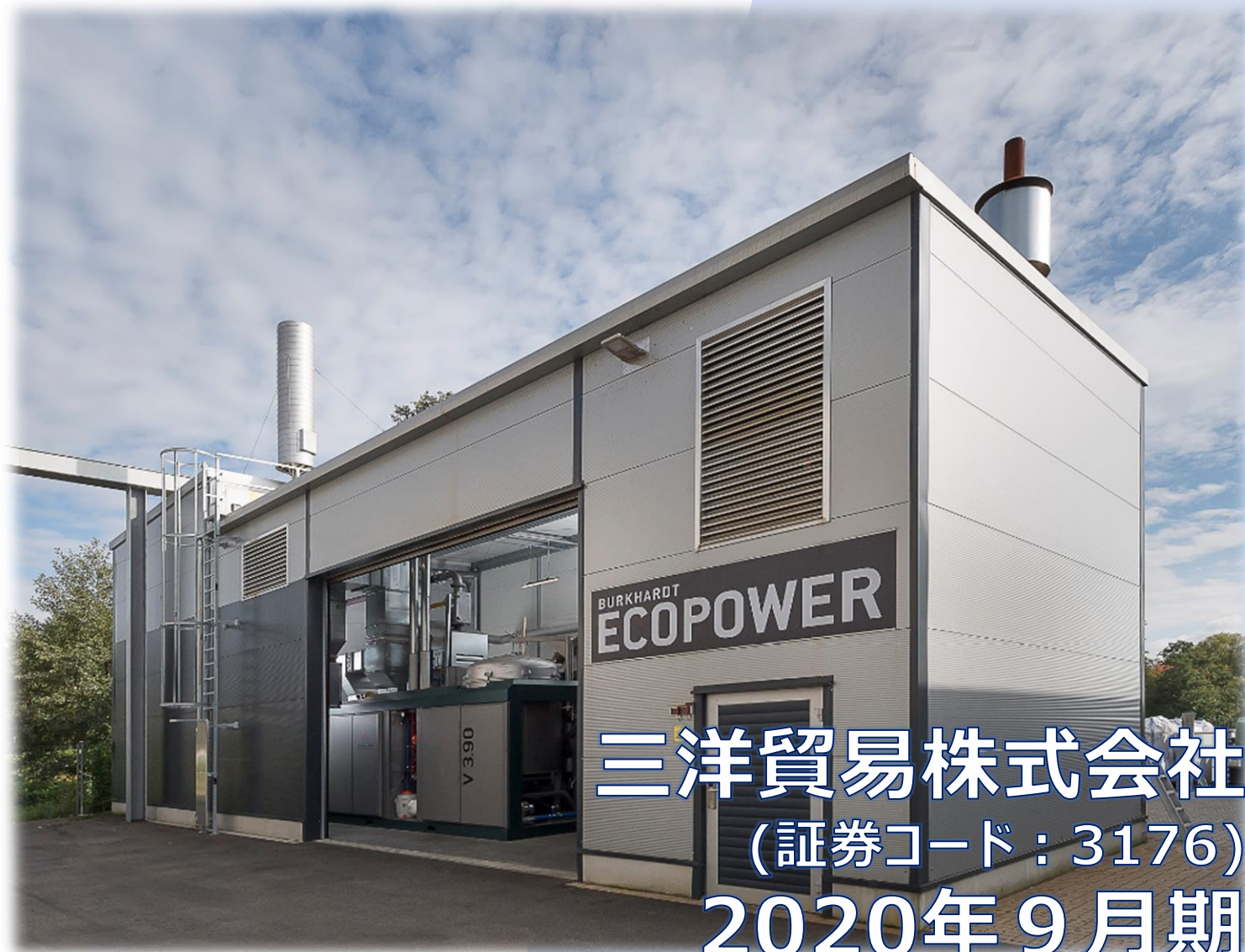
ドイツの木質バイオマス熱電供給施設
