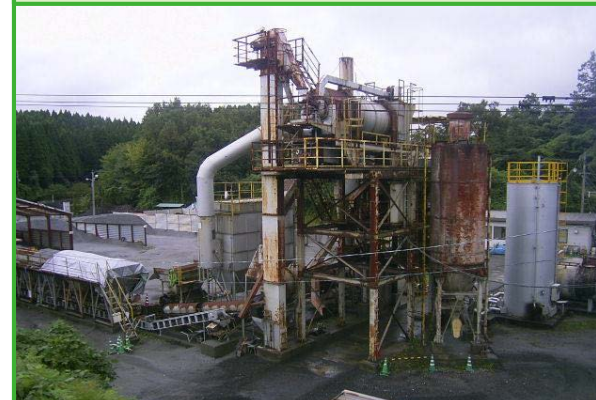
山都合材工場（熊本県） ◀更新前▶
