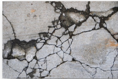
コンクリートの寿命は40～50年とも。 強靱化には「解体」が必須
