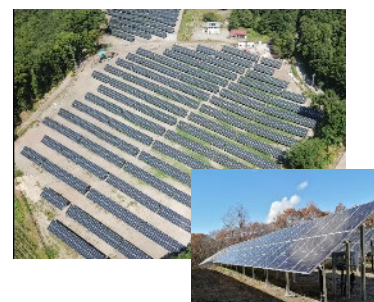
稼働済の太陽光発電所
