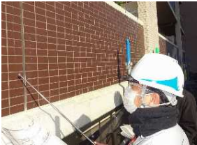
外壁タイルの長期点検制度
