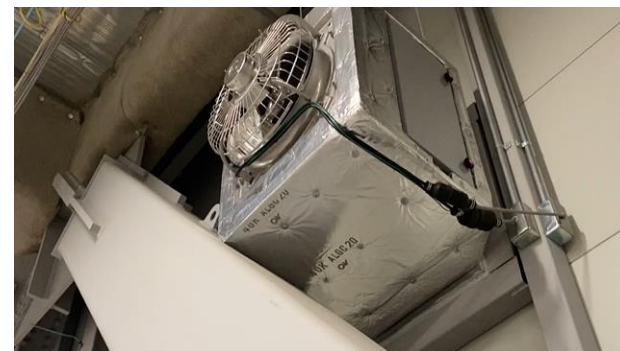
産業用有圧換気扇6基で強力換気 約2時間で全ての空気を入れ替え
