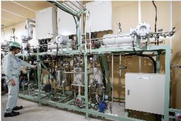
水素発生装置
