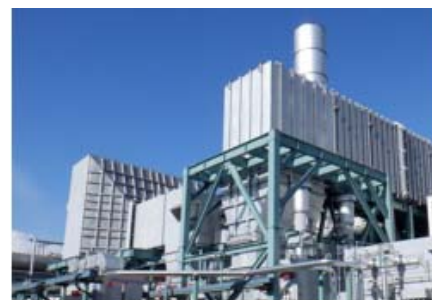
三井化学(株)高効率ガスタービン発電システム
