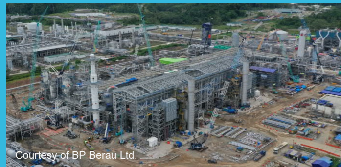
タンゲーLNG
